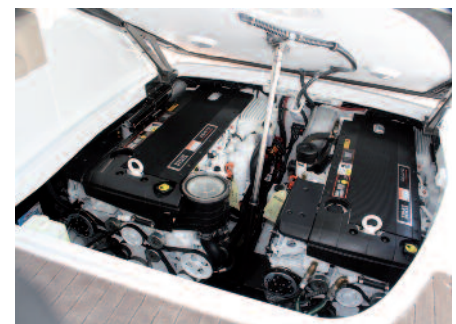
Die beiden Volvo Penta-Diesel D6 370 sauber installiert unter der hydraulisch zu hebenden Achtersektion.
