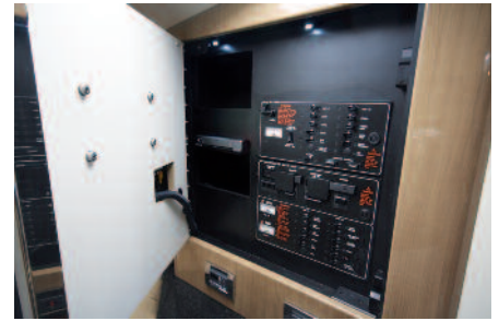
Saubere Sache, die elektrische Schaltzentrale im Salon hinter dem Flachbild-TV.
